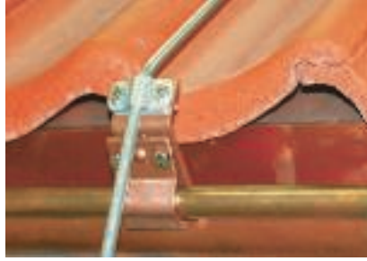
Oikein tehty asennus bimetalliliittimellä (alumiini/kupari)
