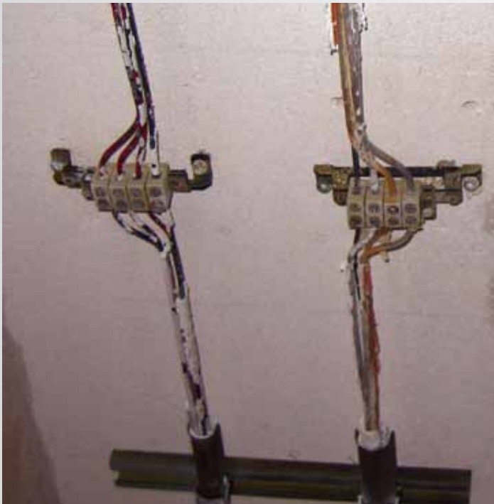
Bild einer Feuerwiderstandsprüfung, die Gehäuse sind verbrannt. Figure of fire resistance test, the boxes are burned.
