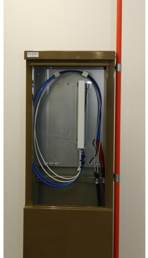
FZVD2PMU Flex -maakaapeli ja kaksi FYO2PMU Mini -talokaapelia asennettuina jatkoskaappiin
