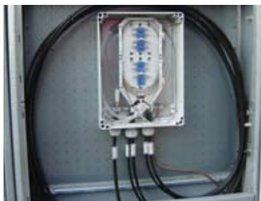
Jatkoskaappi NC-300 asennettuna
