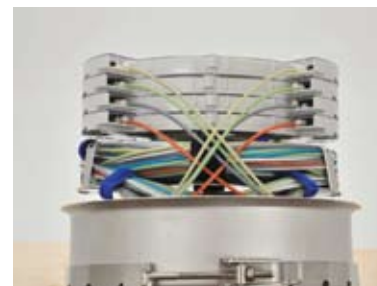
Kaapelin kylkiotto tehtynä TBK8 240/150 -jatkokoteloon
