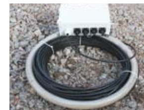
Valmiiksi päätetty mastokaapelipkt, FTTA
