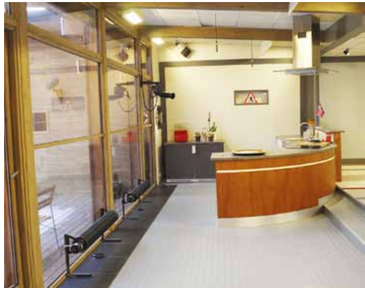
Ikkunan viereen asennettuna ripaputkilämmitin torjuu tehokkaasti suurten lasitettujen pintojen viereen syntyvää vetoa.
